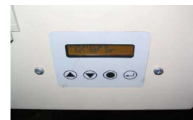
PANNEAU DE CONTRÔLES SUR COMPOSTEUR
